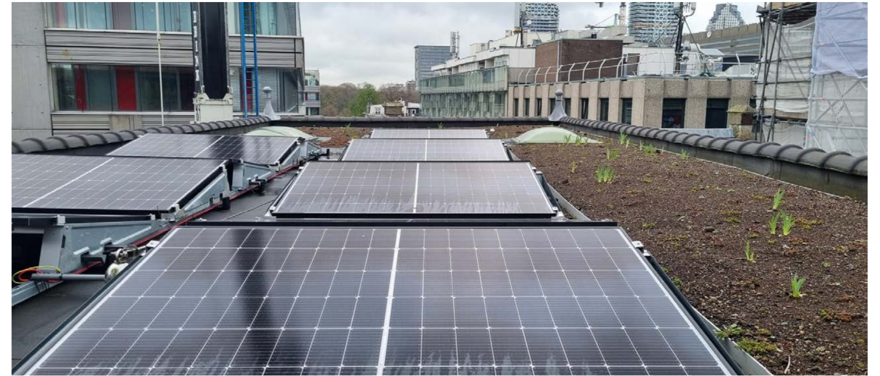
Zonnepanelen en een substraatlaag met 14 sedumsoorten op het dak van de Schouwburgstraat in Den Haag (foto: Erwin Veenstra)
